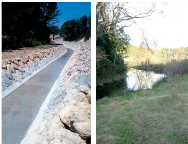
Exemple de mauvaises pratiques de travaux sur un vallon du bassin versant
